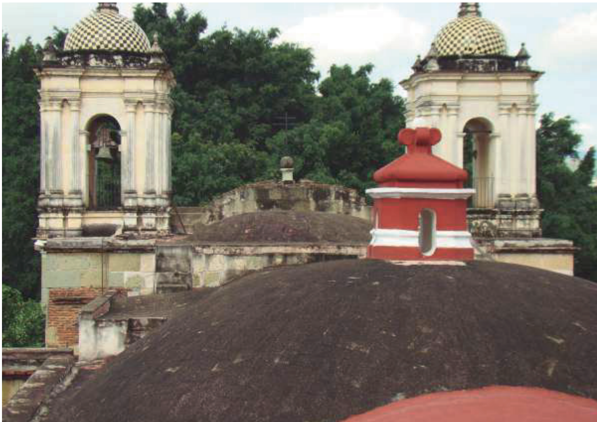
Deterioros que presentaba la cubierta del Templo antes de la intervención
