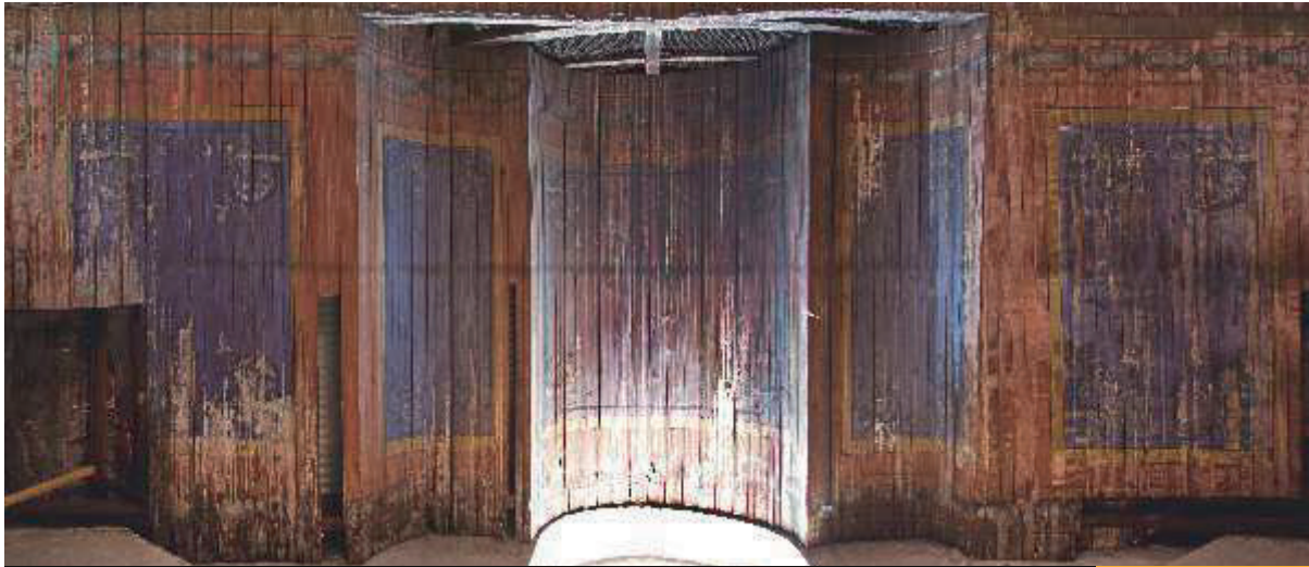
Anverso del artesonado en el área del coro antes del proceso.
