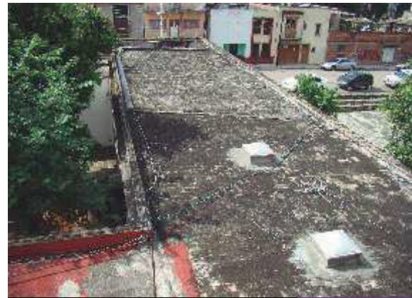
Deterioros que presentaba la cubierta del curato antes de la intervención
