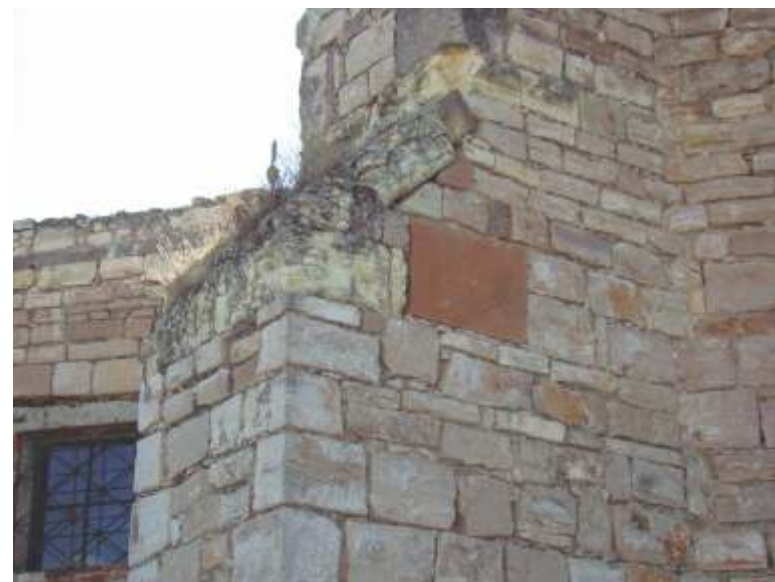
Exfoliaciones de piezas pétreas y presencia de flora nociva en contrafuertes
