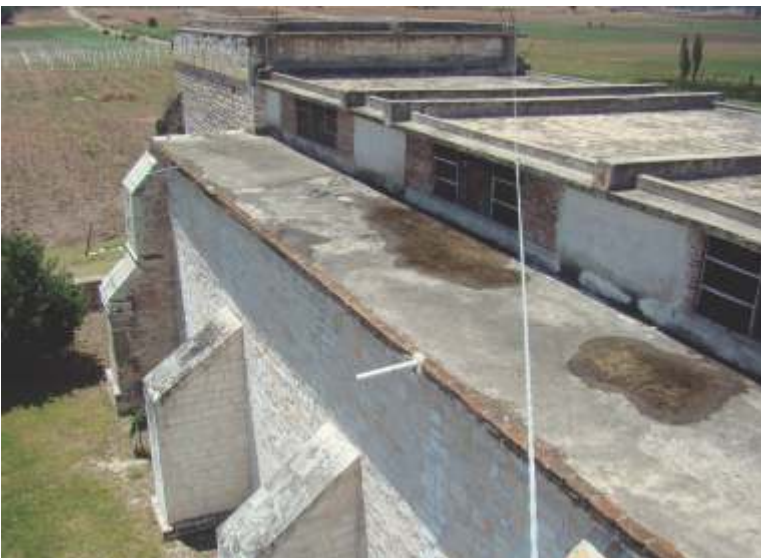
Deterioros en losas de cubierta, acumulación de humedad que se ve reflejada al interior del edificio.
