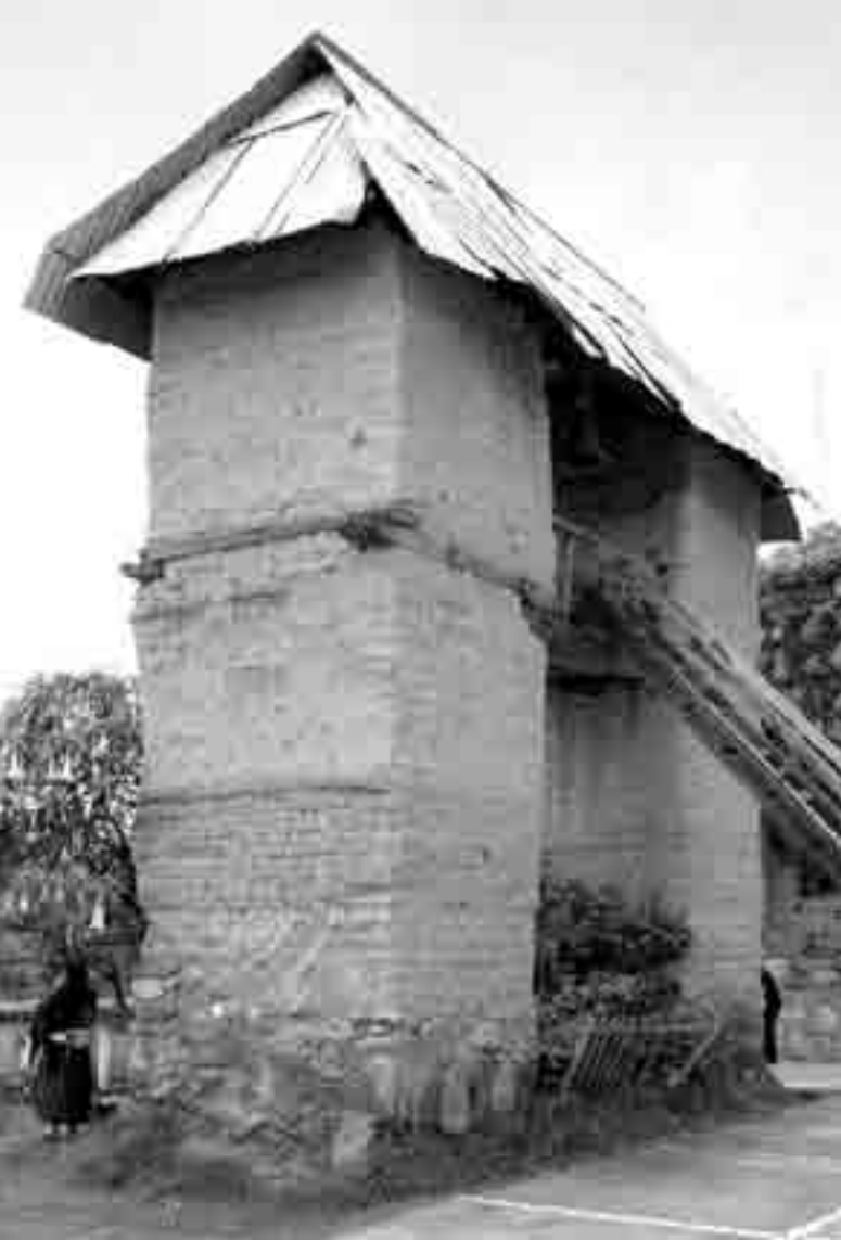
Campanil del templo de Santiago Tlazoyaltepec, estado de conservación antes de su intervención / Archivo INPAC.
