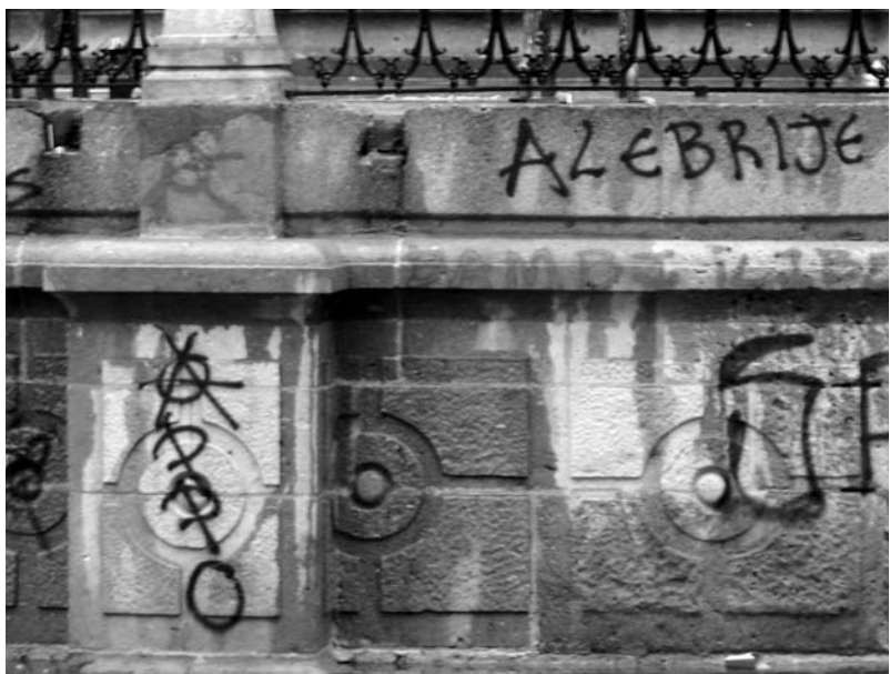
Daños ocasionados al quiosco del Zócalo / INPAC, 2006.
