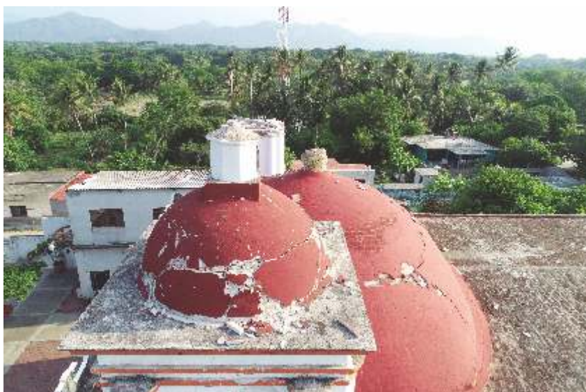
GRIETAS EN BOVEDAS Y COPULIN EN EL TEMPLO DE LA PARROQUIA DE SAN JERÓNIMO DR. CD IXTEPEC.
