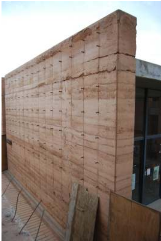
La inadecuada proporción de las tapias y la rigidez de la estructura incidieron en la presencia de fallas en los muros aún sin haberse presentado sismos fuertes. Escuela de Artes Plásticas, Oaxaca
