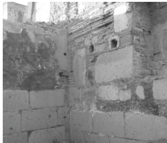
Coro del Templo. Cornisas de imposta recicladas como sillar, foto antes de la intervención. Enero 2007 / Fotografía del autor
