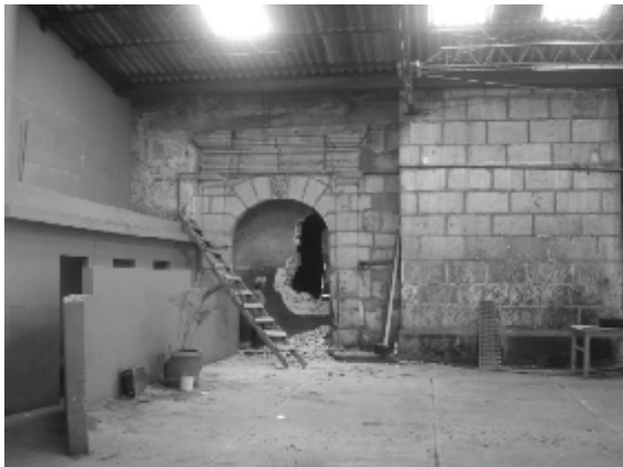
Apertura del muro que tapeaba el vano de acceso al Convento/Fotografía del autor
