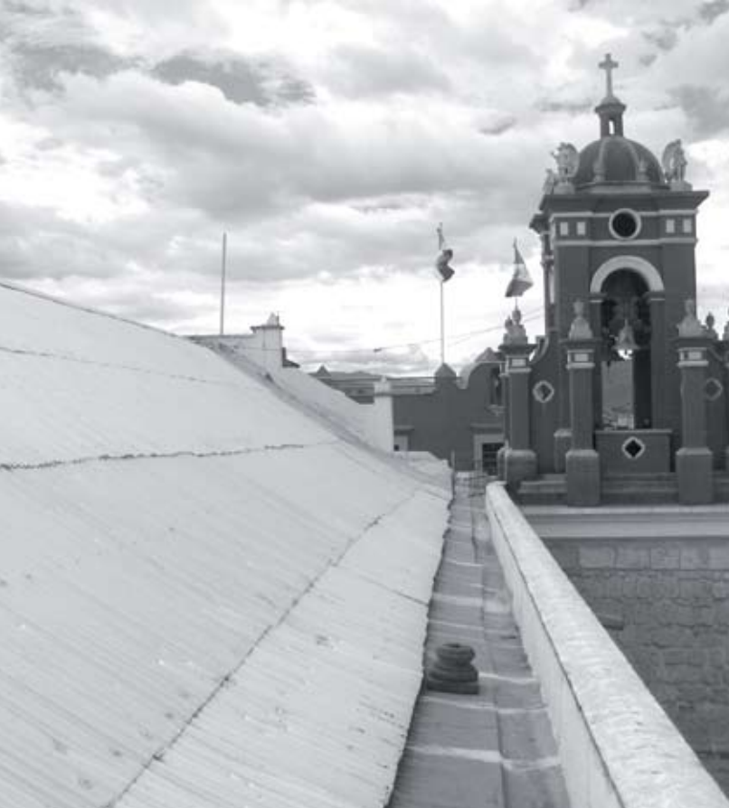
Estado de conservación antes de su intervención / archivo INPAC
