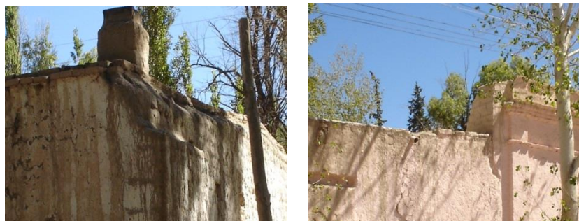
Figura 7 y 8: Patología en mampostería de adobe: Humedad por filtraciones. Fuente: Ana Valeria Pochi y Juan Arturo Pereyra
