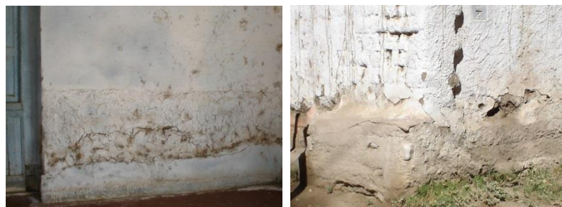
Figuras. 5 y 6: Patología en mampostería de adobe: Humedad proveniente del suelo. Fuente: Ana Valeria Pochi y Juan Arturo Pereyra
