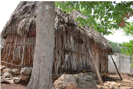
Figura 3: Vivienda maya con deterioro por falta de mantenimiento, Santa María, Campeche. Fuente: Sánchez, 2015
