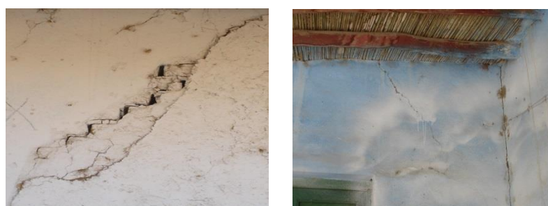
Figura 9 y 10 Patología en mampostería de adobe: Grietas y Fisuras. Fuente: Ana Valeria Pochi y Juan Arturo Pereyra
