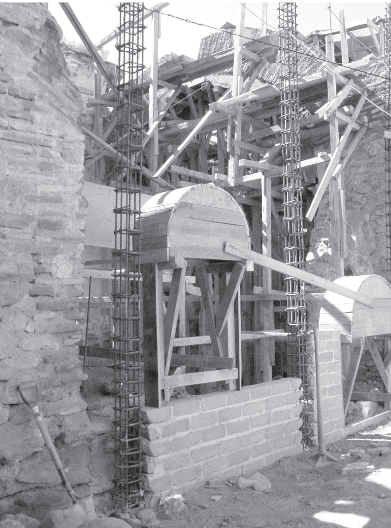
Intervención errónea en la capilla de Macuilxóchtli, Oaxaca.
