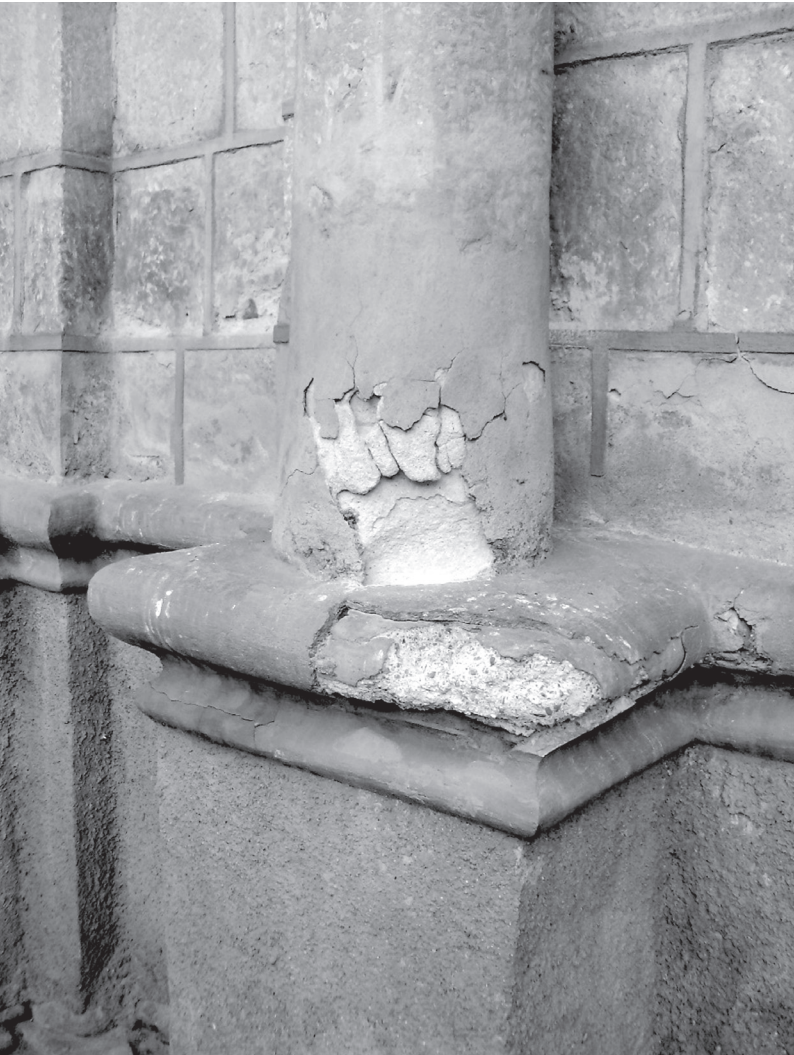
Deterioro en la piedra provocado por el aplanado de cemento.
