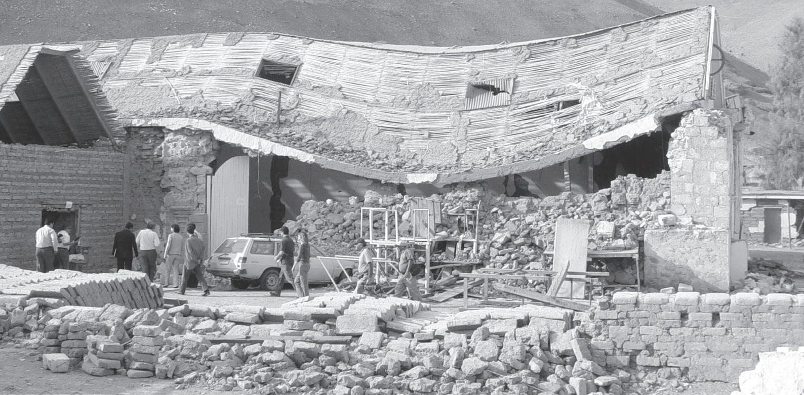
Muro de adobe destruido por un refuerzo de concreto armado después de un terremoto. San Lorenzo de Tarapacá, Chile.
