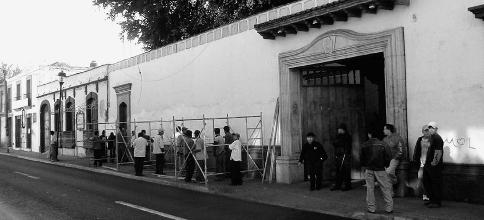
Habilitado de andamios antes de iniciar la intervención de lo que fuera la Casa Oficial del Gobierno del Estado de Oaxaca / INPAC
